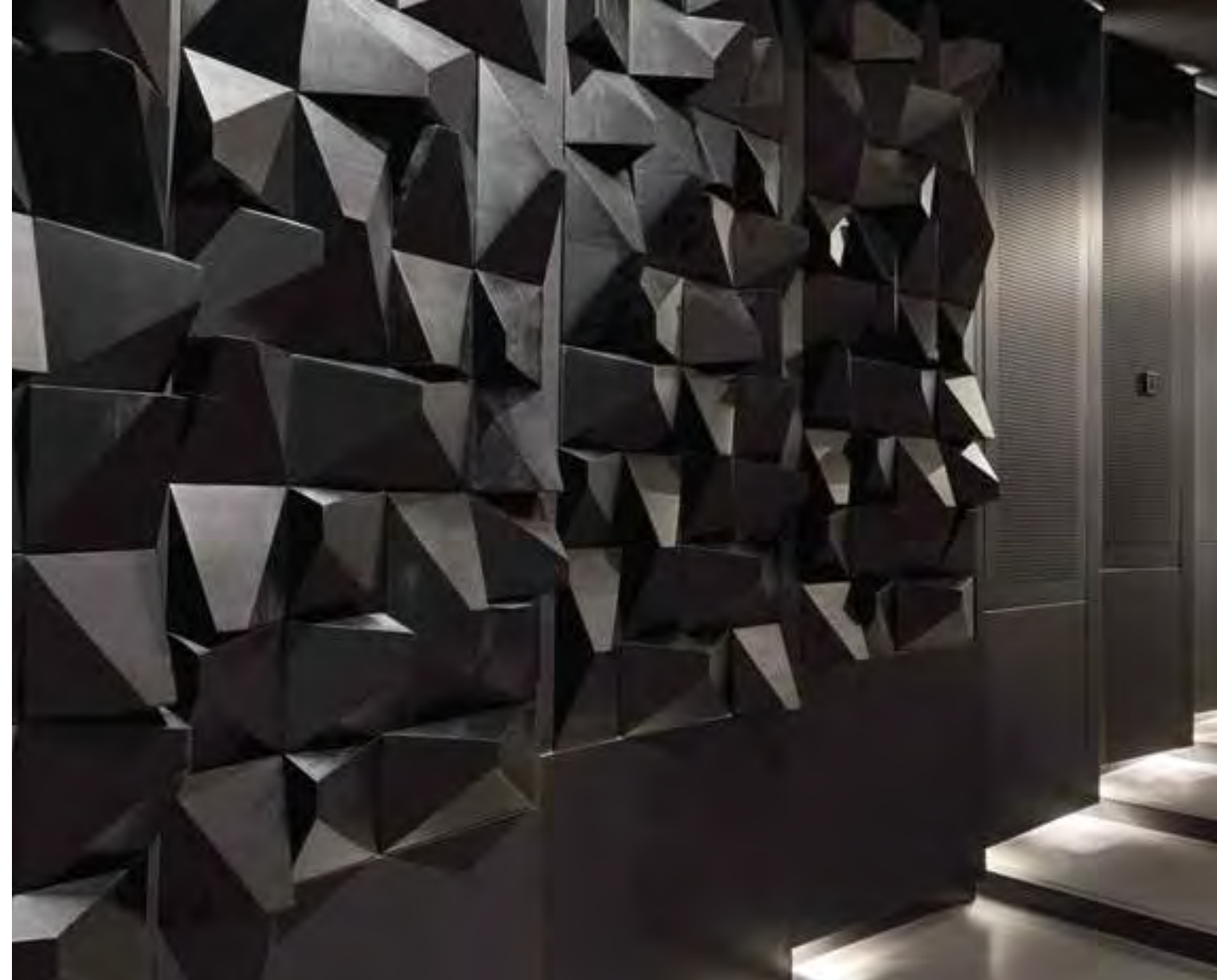
FÜLÖP Krisztina: A budapesti Örkény István Színház nézőtere – diffúzorok és hangelnyelő panelek Krisztina FÜLÖP: Auditorium of the Örkény István Theatre, Budapest – diffusers and sound absorbing panels Fotó: Barakonyi Szabolcs
